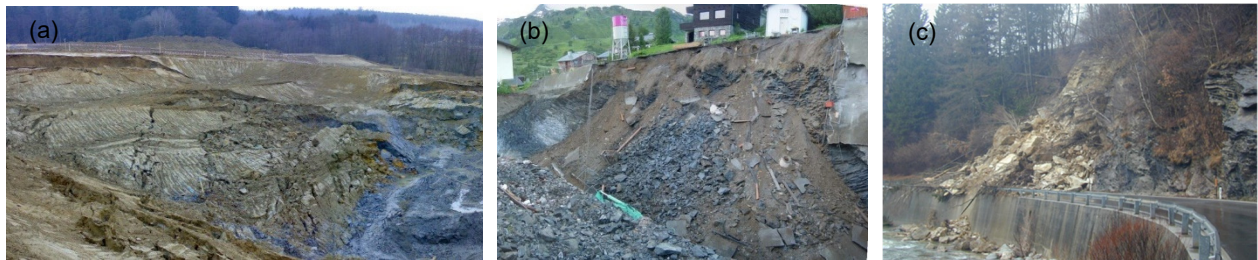
Abbildung 1. Ausgewählte Schadensfälle: (a) Errichtung einer Baugrube in Bad Waltersdorf – Oststeiermark, (b) Versagen einer Baugrubenwand in Obertauern – Salzburg, (c) Böschungsbruch entlang der B99 Katschberg Bundesstraße [Quelle: GDP ZT GmbH]
