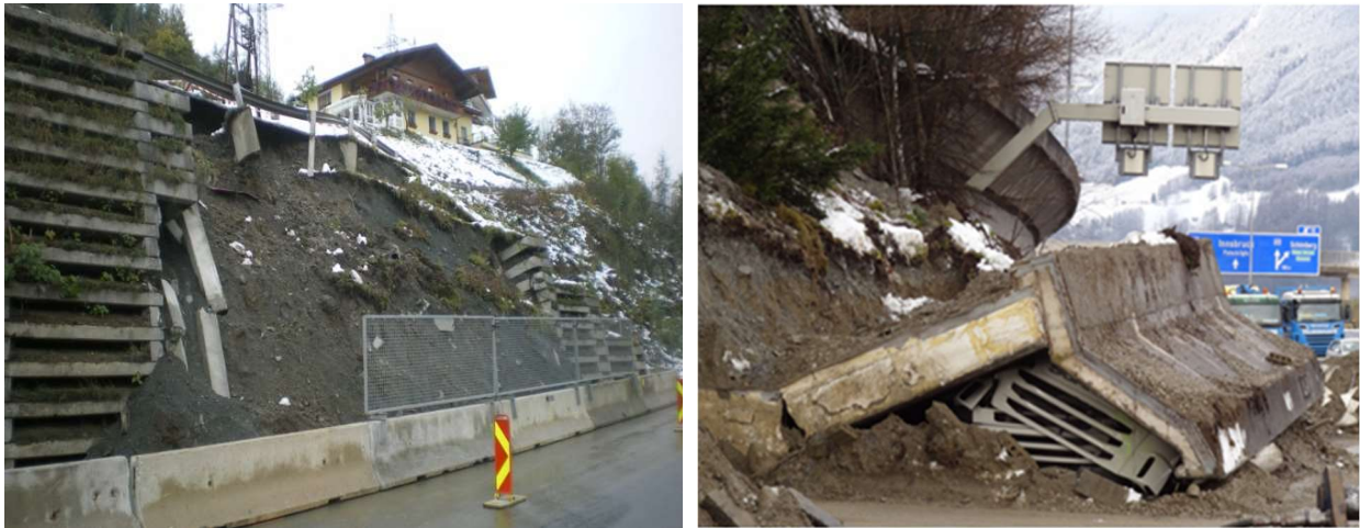
Abb. 1: Links: Teilstreckensperre nach einem Wandverbruch in Salzburg (Quelle Land Salzburg); Rechts: Wandverbund mit Todesfolge entlang der Brenner-Autobahn (Quelle: Marte et. al.)
